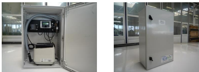
Figure 8: La boîte de commande ou de pilotage interne «l'armoire en PRV»
